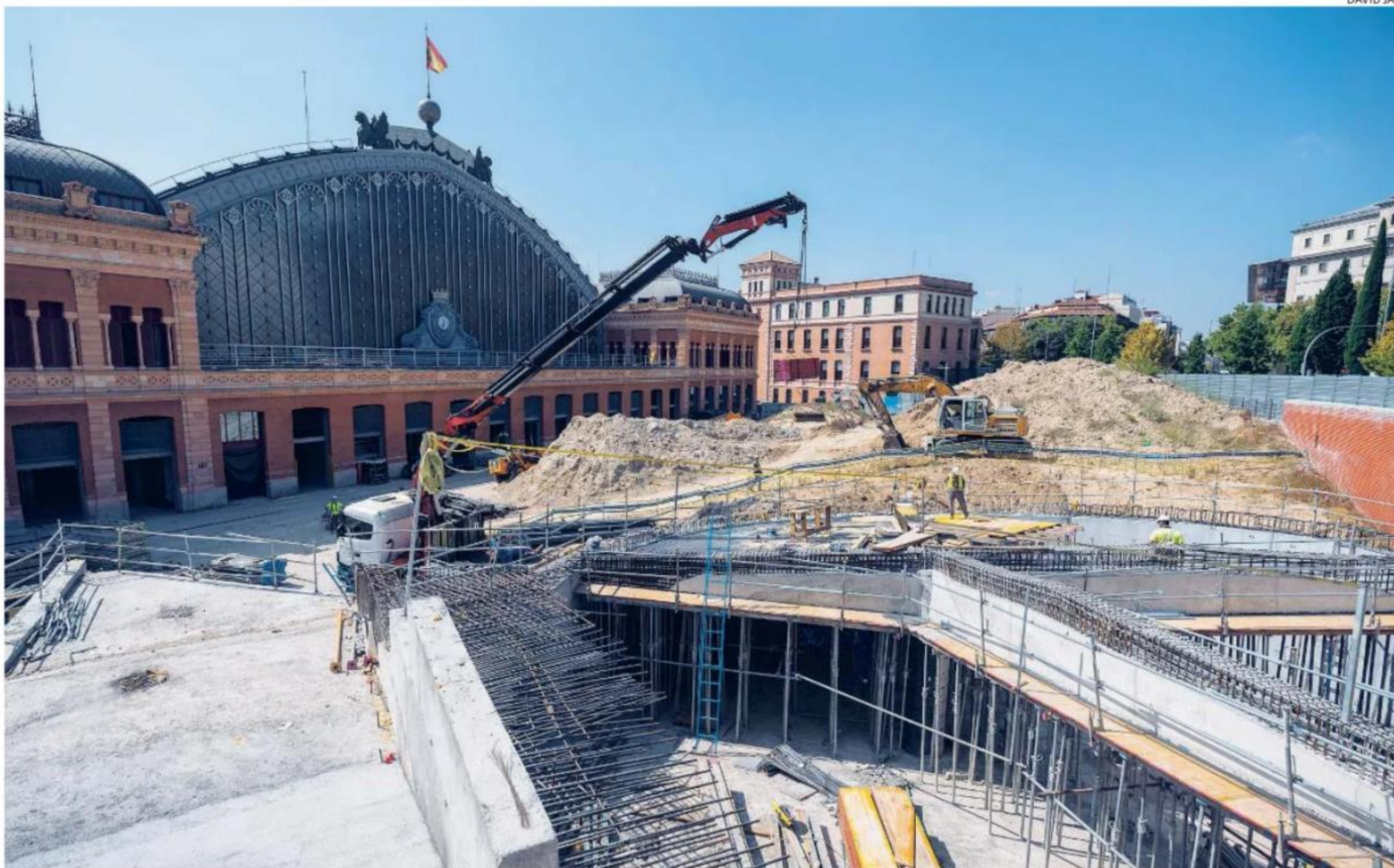
Obras en la estación de Atocha, donde se está llevando a cabo la construcción de un aparcamiento. También se remodelará la marquesina histórica
